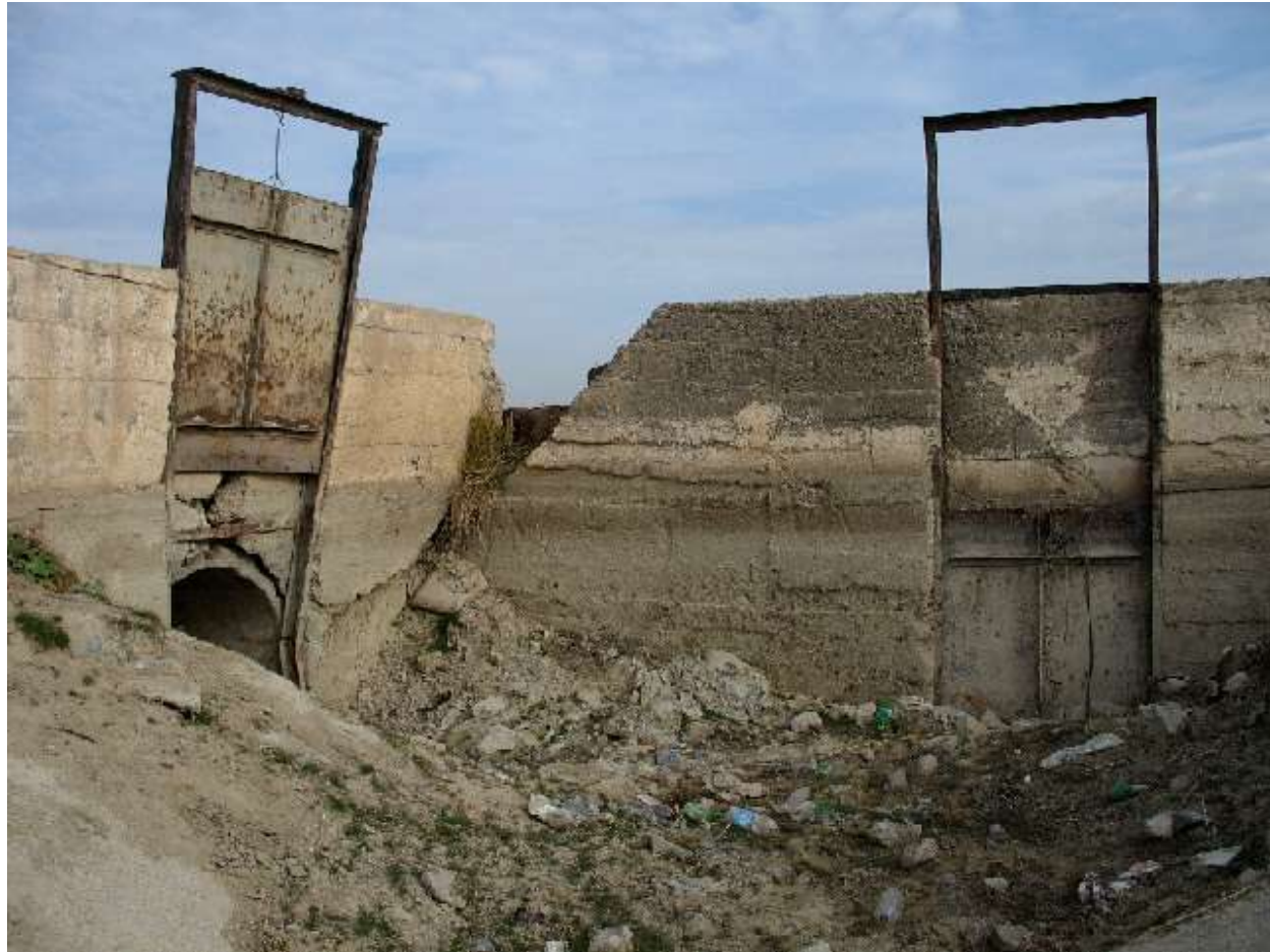
Станция распределения воды Бакбакты (Балхашский бассейн)
